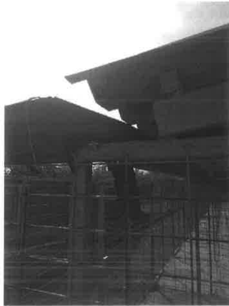
Εικόνα 3: Κατεστραμμένο δίκτυο υδροσυλλογής.
